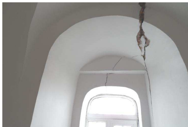
Рисунок 5. Трещины над оконными проёмами средней части, разделяющие свод на отдельные арки.
