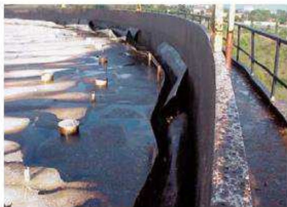
Рисунок 5. Подъем плавающей крыши в результате колебаний жидкости внутри резервуара.
