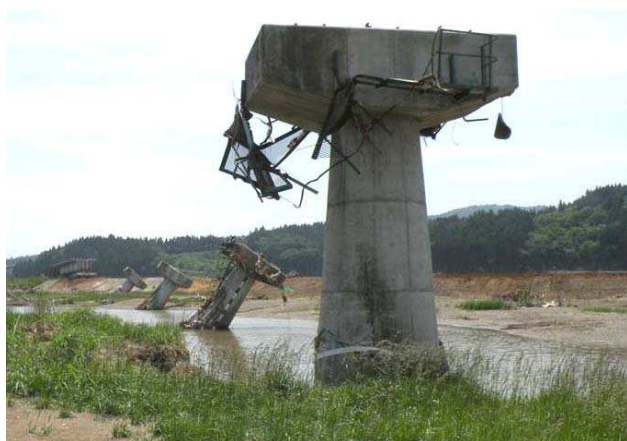
Рис.5. Опрокидывание колонн виадука в Койзуми-о-Хаши (префектура Фукусима, Япония), в результате землетрясения в марте 2011 г.
