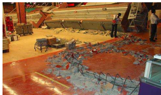
Рис.3. Разрушение фундаментной плиты торгового здания в префектуре Ниигата землетрясением интенсивности 6.6 баллов в июле 2007 г.
