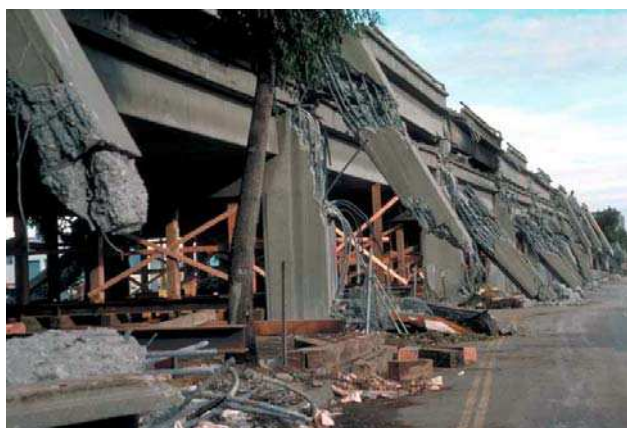
Рис.4. Виадук в Сан-Франциско, разрушенный землетрясением интенсивности 6.9 баллов в октябре 1989 г.
