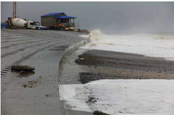
Рис. 7. Оттягивание пляжа от сооружения и оголение ростверка во время шторма
