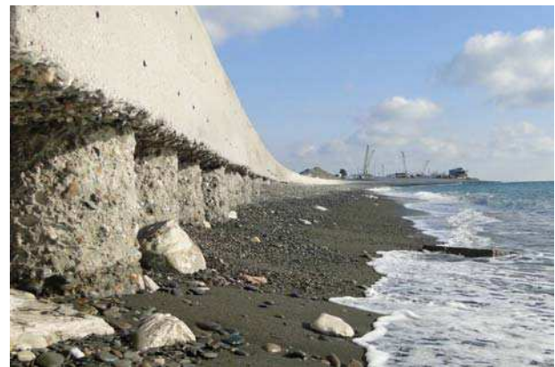
Рис. 9. Вид ростверка на сваях после шторма в районе оградительного мола порта
