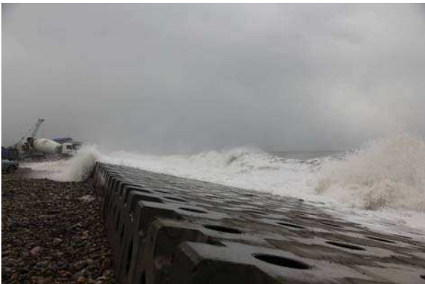
Рис. 6. Перелив через построенное сооружение
