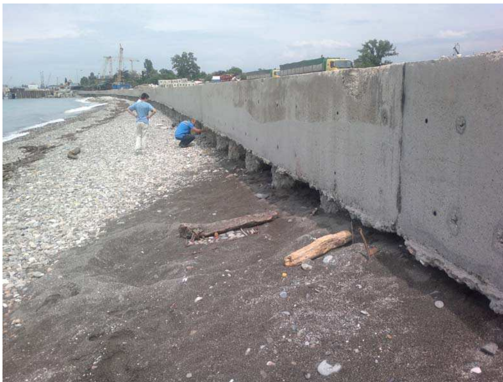
Рис.3. Берег в районе ПК18 (фото МГСУ, июль 2011), пляж размыв значительно, ростверк оголен полностью
