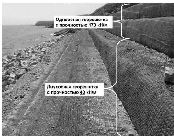
Рис. 4. В основании сооружения георешетка с прочностью в 4,25 раза меньше требуемой.
